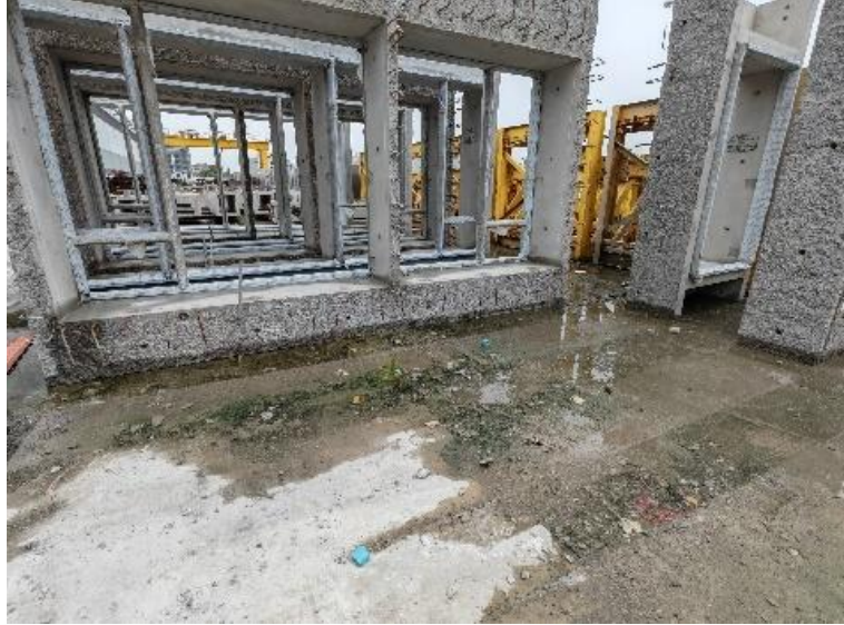
图 4-3-1 预制构件堆场积水错误
